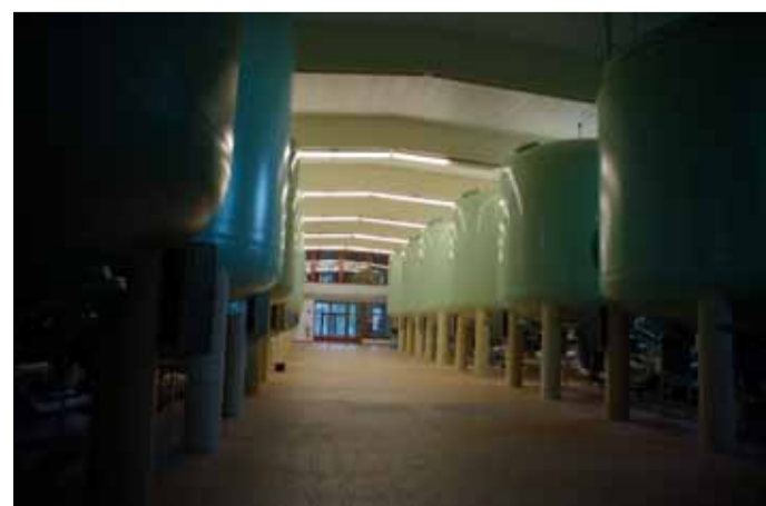
Kessel mit Eisen- und Manganfiltern.
